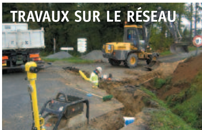
Travaux sur le réseau : d'importants moyens sont souvent mis en œuvre pour assurer rapidement une réparation. Il n'est jamais agréable de vivre une journée sans eau.
